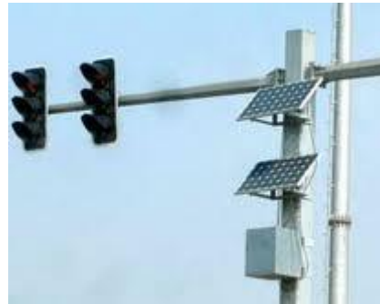
Figura 5 Panell fotovoltaic semàfor
